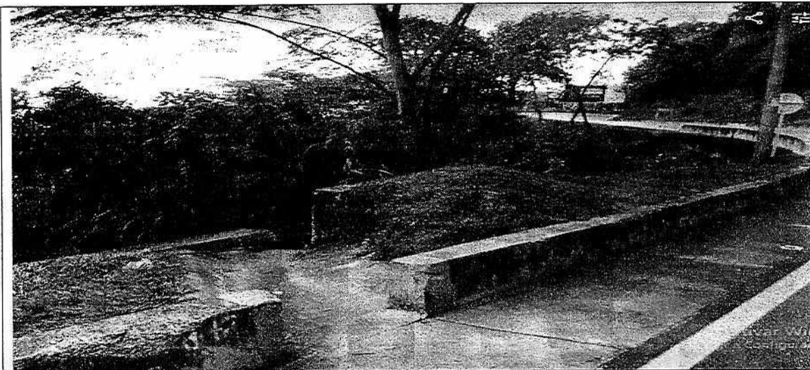
Figura 5. Estado actual del globo de vía Km 8+200, No se evidencia ocupación o perturbación sobre estructura de alcantarilla.
